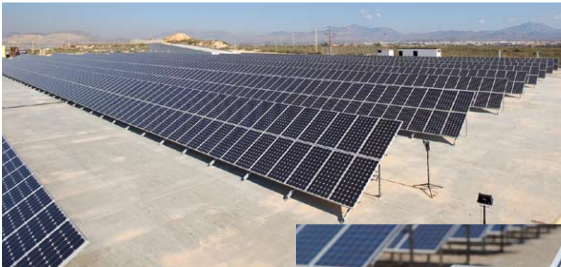
Bildquelle: SMA Solar Technology AG
