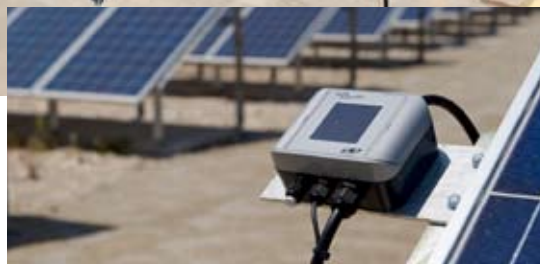
Bildquelle: SMA Solar Technology AG
